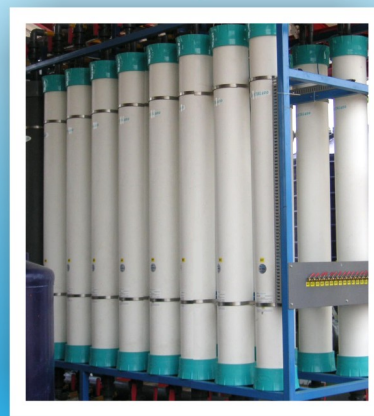
UF Module on skid
